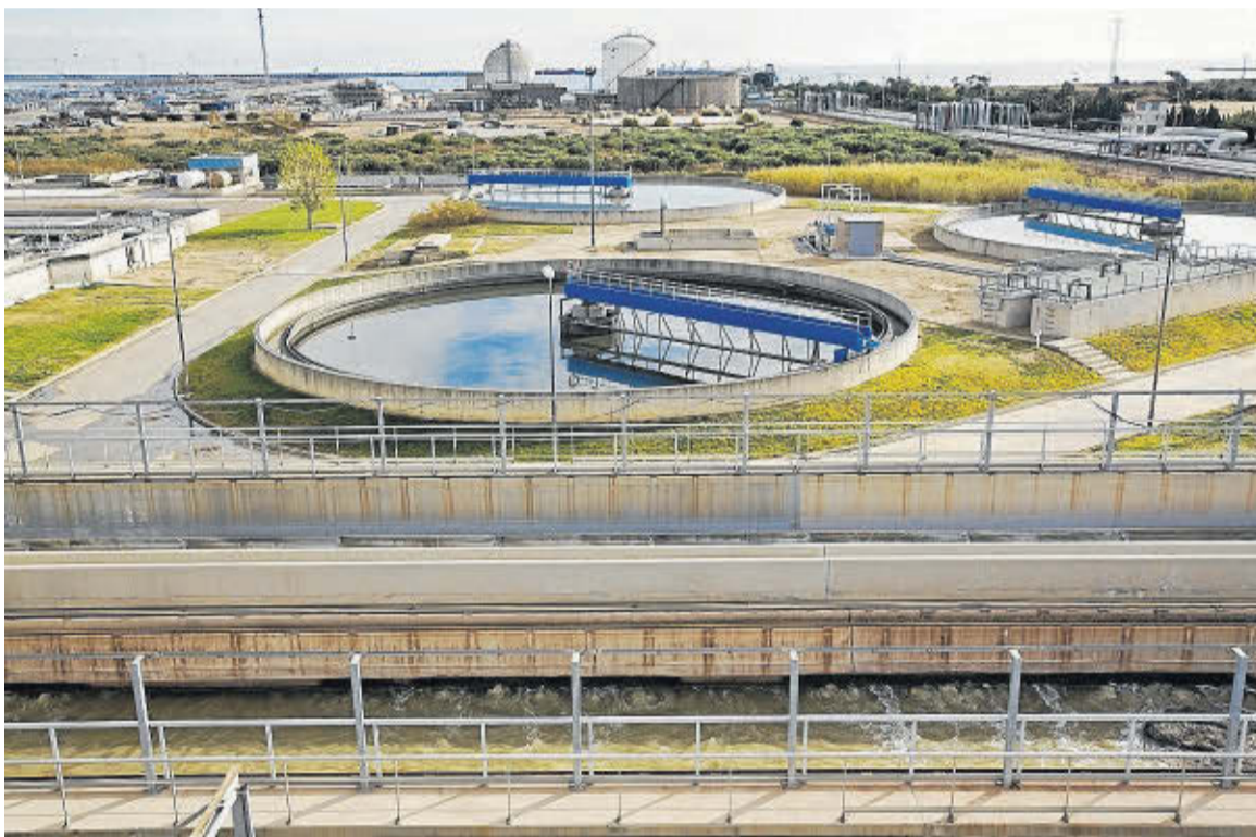
Imagen de la Estación Depuradora de Aguas Residuales (EDAR) de Vila-seca y Salou. FOTO: ACA
